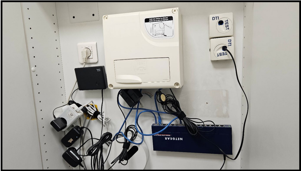
Branchement du réseau avec Freebox, switch alimente le réseau ethernet de la salle audio
